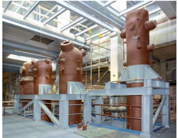
Рис. 2: Подогреватели питательной воды высокого давления на теплоэлектростанции в г. Ювяскюля, Финляндия.
