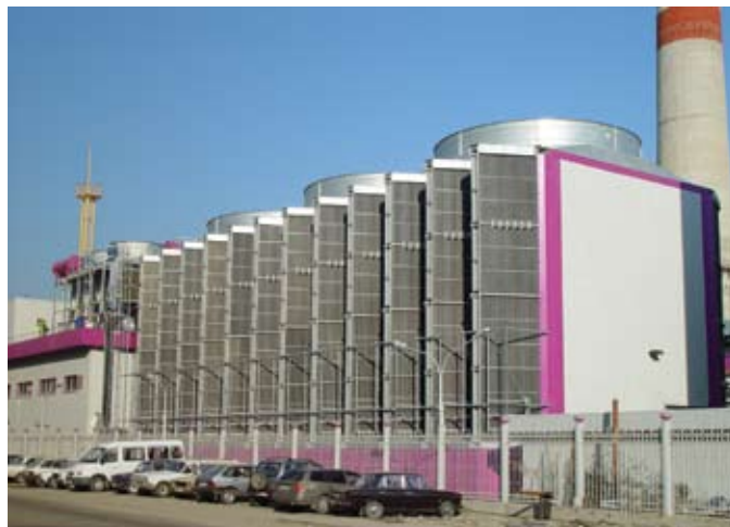
Рис. 5: Сочинская ТЭС (мощность 80 МВтэ), г. Сочи, Россия, оснащенная системой Геллера с дополнительным орошением (Собственник и контракт на EPC: Интер PAO EЭС)
