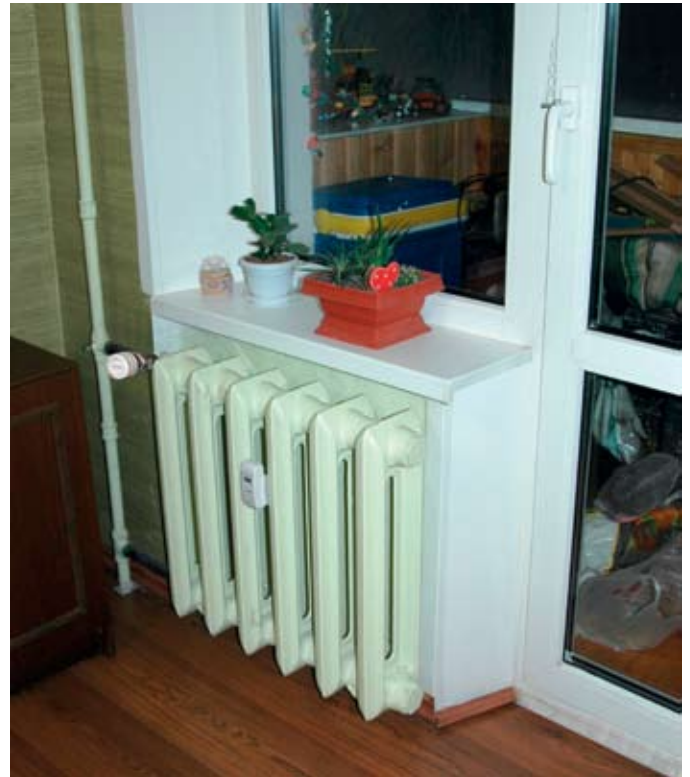
Радиаторный терморегулятор и счетчик - распределитель тепла на отопительном приборе Radiator thermostat and individual heat-meter installed on the radiator
