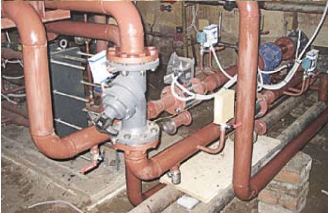
После модернизации ИТП в здании After modernization of heating systems
